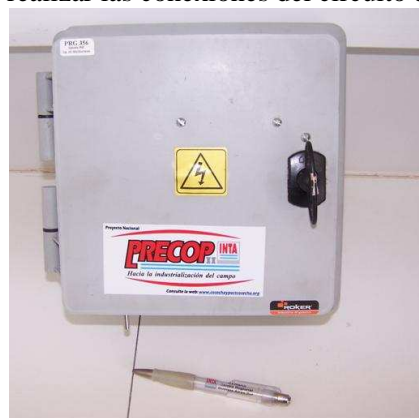
Figura 4. Imagen del controlador de aireación cerrado, donde se aprecia el detalle del tipo de gabinete utilizado.
